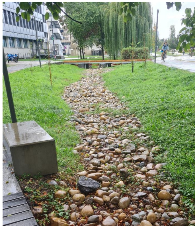
Rivière sèche, ouvrage d'infiltration sur le campus de la Doua (©Master2 IWS)
